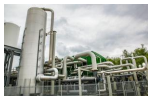
Akumulace elektřiny do zkvalněného vzduchu – kryobaterie
